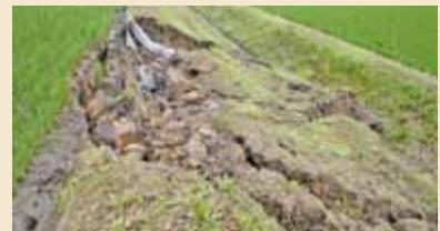
大雨による法面崩壊 紫波町犬淵地内
