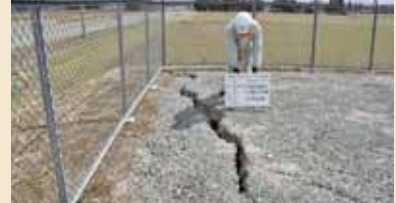
地震による法面崩壊 花巻市石鳥谷町八幡地内
