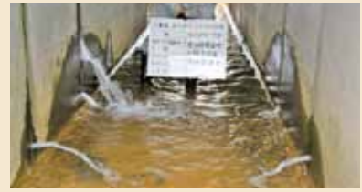
地震によるパイプライン漏水 紫波町土館地内
