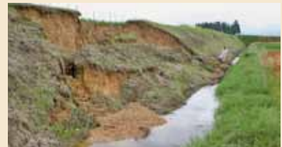
大雨による法面崩壊 紫波町片寄地内
